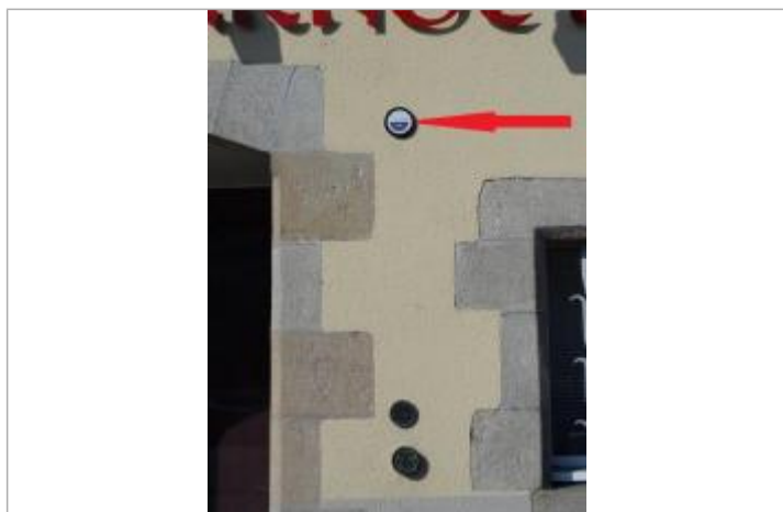
Repère disparu de la crue du 13 décembre 2000
