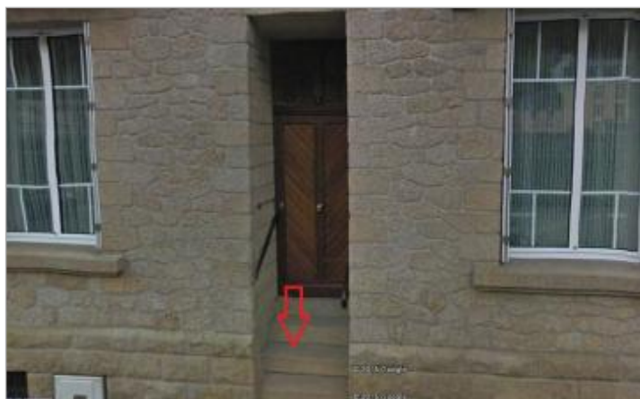
Niveau d'eau sur la deuxième marche de l'entrée
