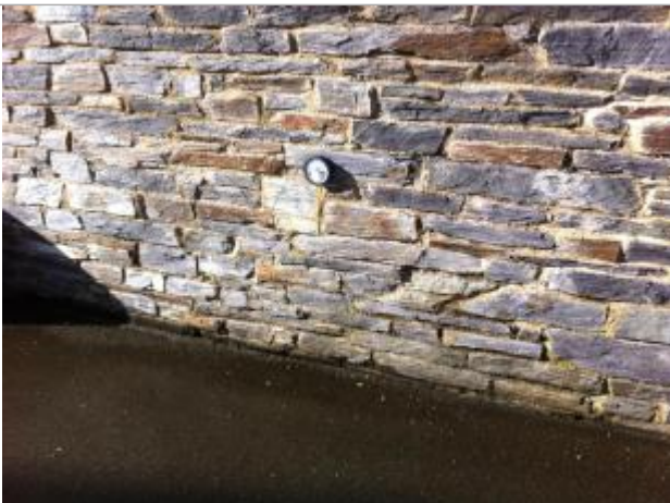
Repère normalisé de la crue de Décembre 2000
