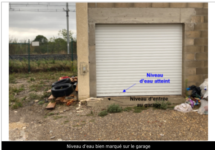
Niveau d'eau bien marqué sur le garage
