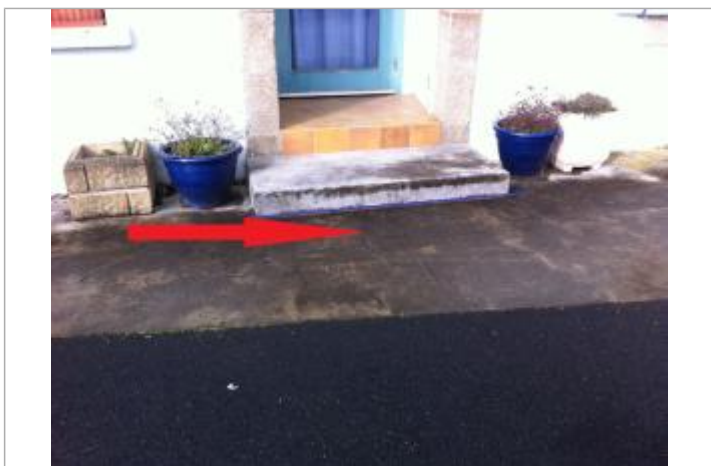
Niveau d'eau au pied de la première marche de l'entrée
