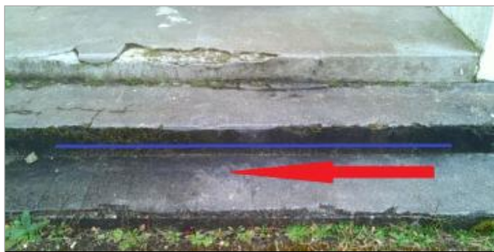
Niveau par rapport à la première marche de l'escalier de l'atelier de mécanique
