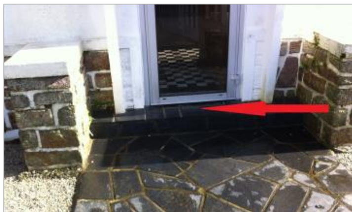
Niveau d'eau en-dessous du seuil de la porte d'entrée
