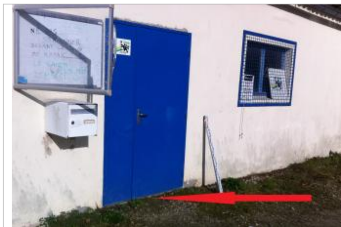
Niveau d'eau dans le bâtiment à partir du plancher
