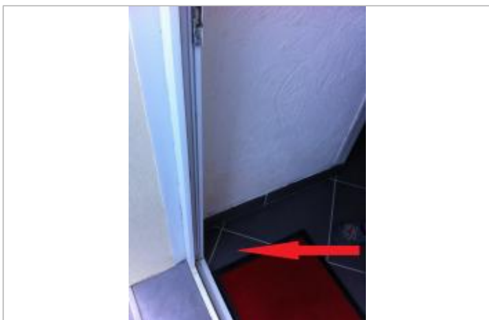
Laisse au niveau de la porte d'entrée
