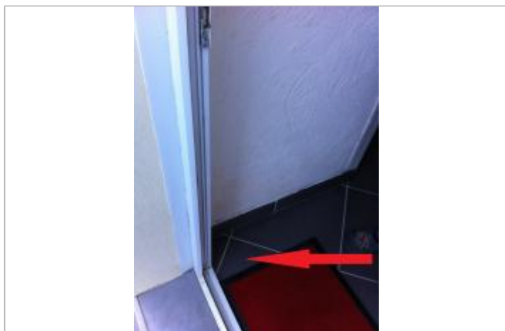
Laisse au niveau de la porte d'entrée
