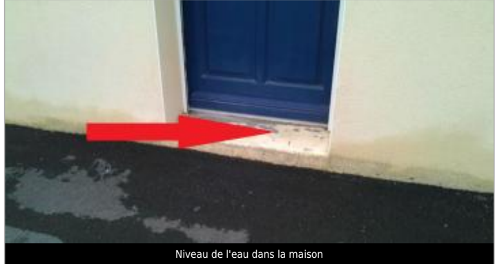
Niveau de l'eau dans la maison
