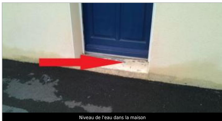
Niveau de l'eau dans la maison
