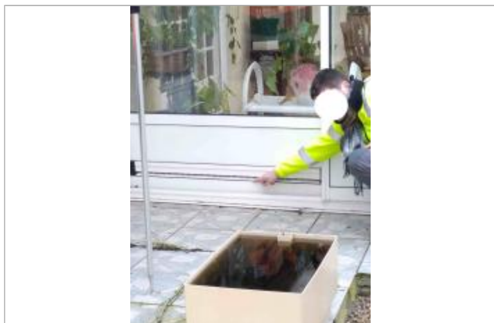
Laisse de crue sur porte de la véranda à 10 cm/sol
