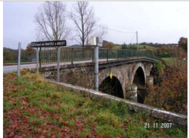
Station limnimétrique de l'Aulne à Chateauneuf-du-Faou
