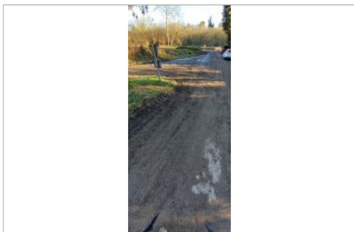
Photo de la laisse - Auteur : Cerema Dter Sud-Ouest
