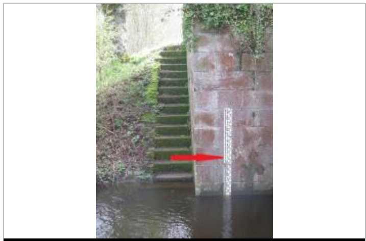
Echelle limnimétrique en amont du pont
