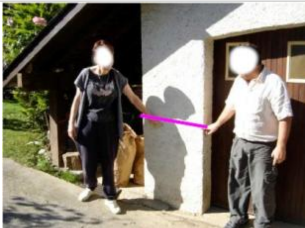
Vue du repère (le trait rose représente le niveau atteint par les eaux) - Auteur : ISL
