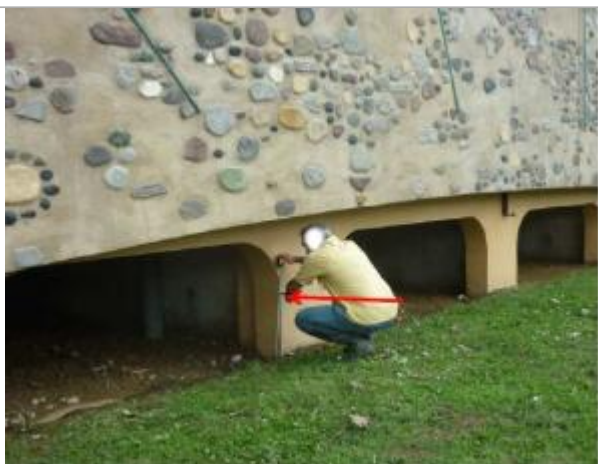
Vue du repère (la flèche rouge représente le niveau atteint par les eaux) - Auteur : HEA/DDTM 64
