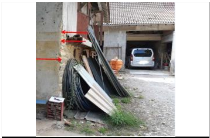
Vue du repère (la flèche rouge du milieu représente le niveau atteint par les eaux) - Auteur : HEA
