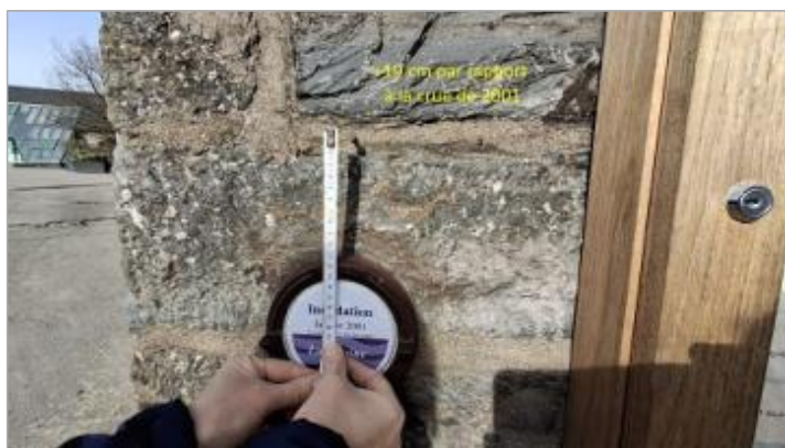
Différence entre la crue de 2025 et le repère de 2001 - photo Conseil Régional de Bretagne - voies navigables
