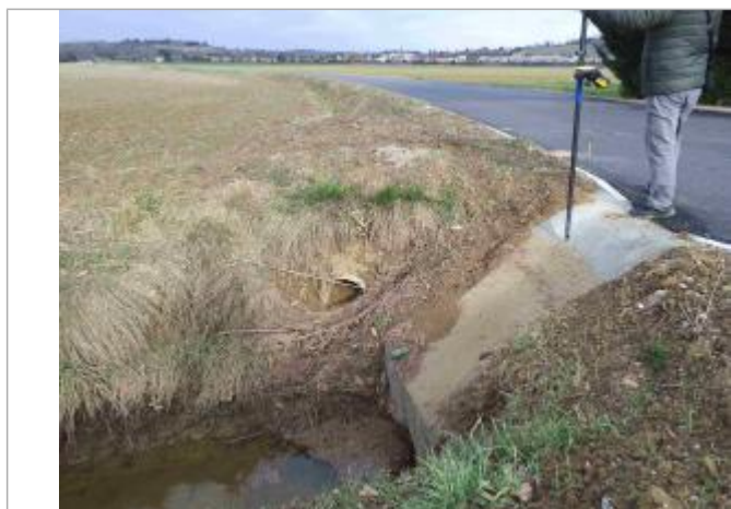
Traces de boues dans le fossé
