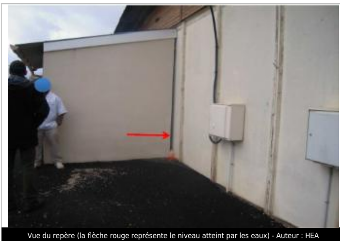
Vue du repère (la flèche rouge représente le niveau atteint par les eaux) - Auteur : HEA
