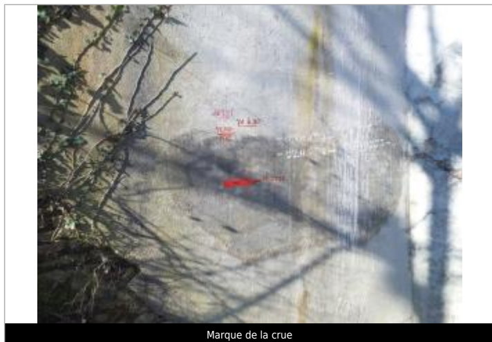
Marque de la crue
