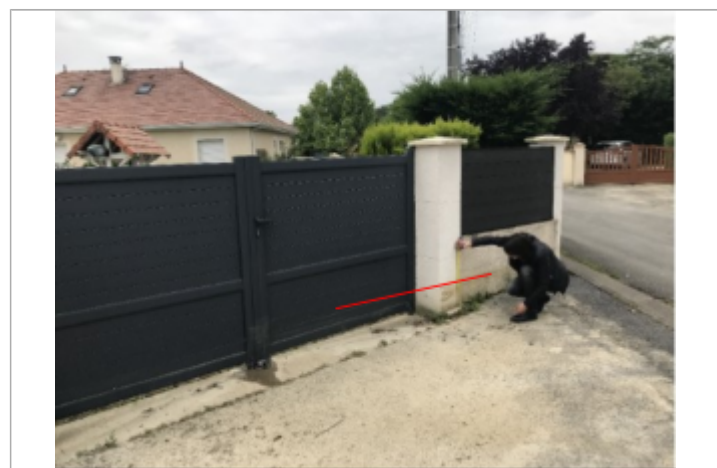
Vue du repère (le trait rouge représente le niveau atteint par les eaux) - Auteur : ARTELIA/DDTM
