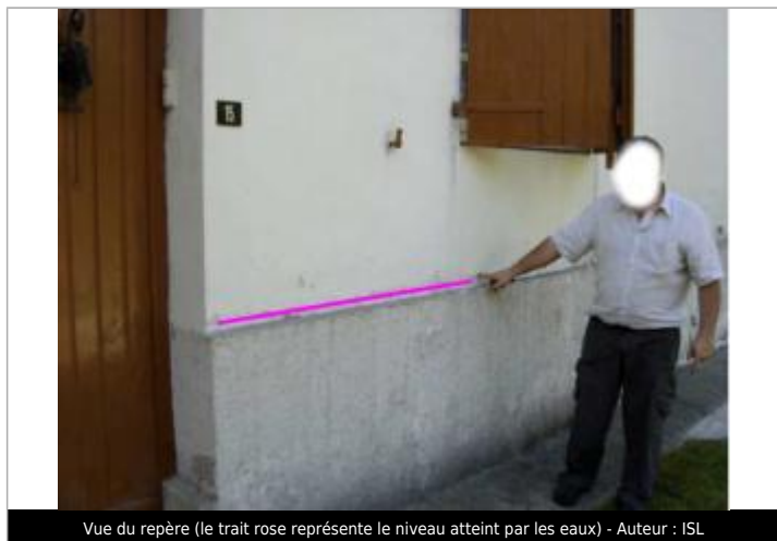
Vue du repère (le trait rose représente le niveau atteint par les eaux) - Auteur : ISL
