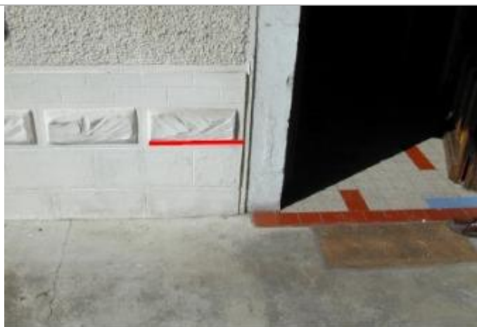
Vue du mur (le trait rouge représente le niveau atteint par les eaux) - Auteur : Géodes
