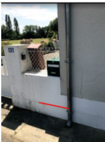
Vue du repère (le trait rouge représente le niveau atteint par les eaux) - Auteur : ARTELIA
