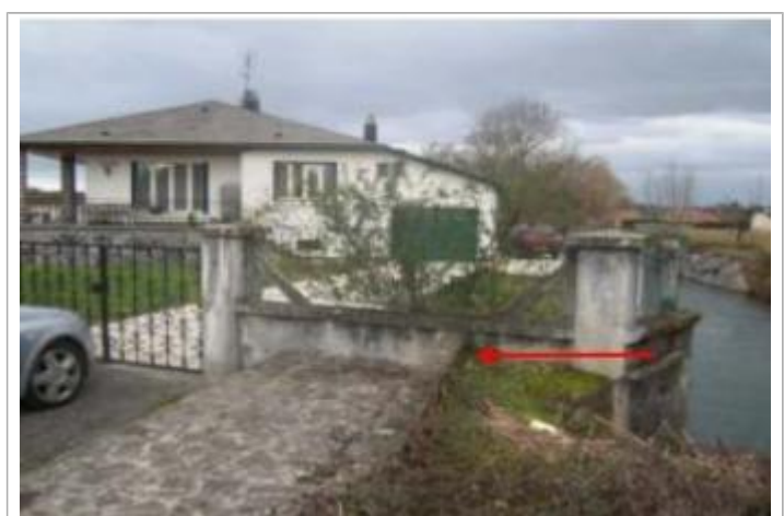
Vue du repère (la flèche rouge représente le niveau atteint par les eaux) - Auteur : HEA
