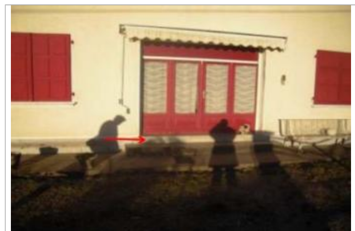
Vue du repère coté rue (la flèche rouge représente le niveau atteint par les eaux) - Auteur : HEA
