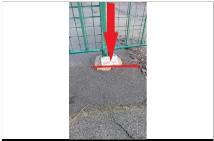
L'eau a atteint le seuil du portail
