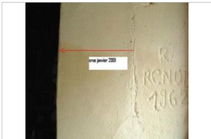
Vue de la trace d'humidité dans la cave du Moulin
