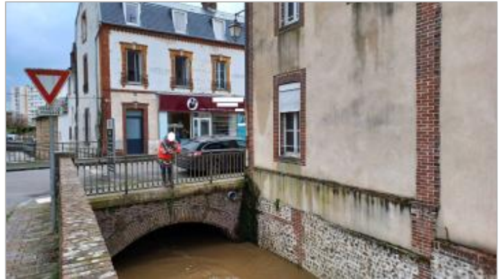
Niveau de l'eau sous le Pont rue du Général De Gaulle sur bras gauche de la Risle.
