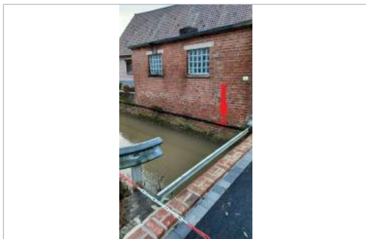
L'eau a atteint le haut du tuyau noir devant le 84 rue du Cornet
