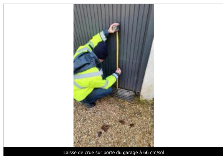
Laisse de crue sur porte du garage à 66 cm/sol
