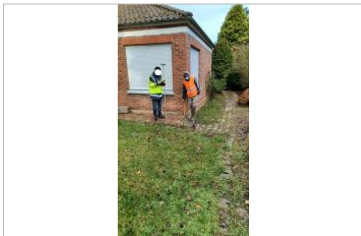
Laisse de crues sur mur de briques sur façade du pavillon à 25 cm du sol
