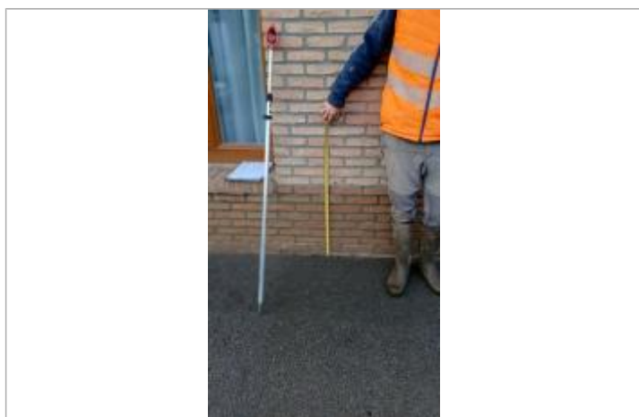
Laisse de crues sur mur de briques sur façade du pavillon à 52 cm/sol
