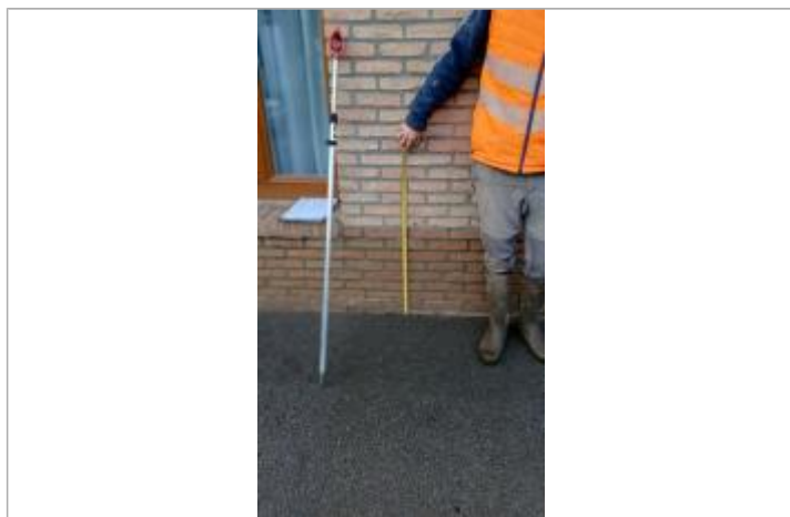
Laisse de crues sur mur de briques sur façade du pavillon à 52 cm/sol
