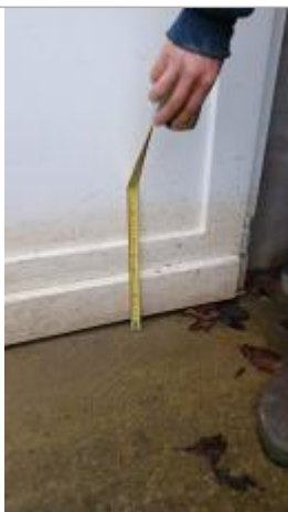
Laisse de crue sur porte en PVC à 32 cm/sol
