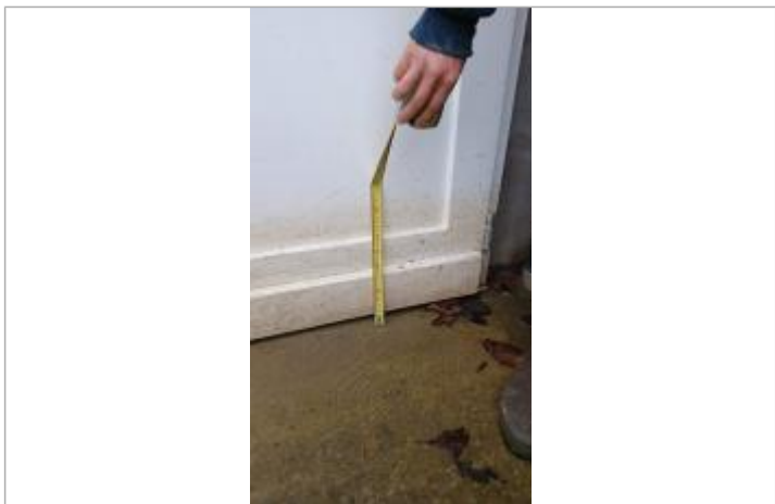
Laisse de crue sur porte en PVC à 32 cm/sol
