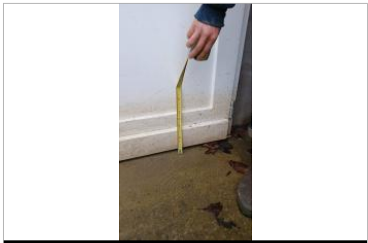
Laisse de crue sur porte en PVC à 32 cm/sol
