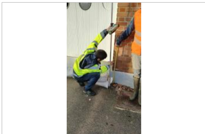
Laisse de crue sur porte de garage à 60 cm/sol
