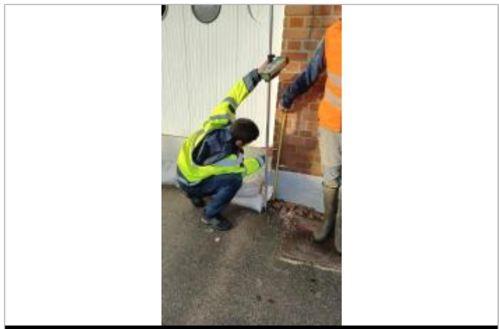
Laisse de crue sur porte de garage à 60 cm/sol
