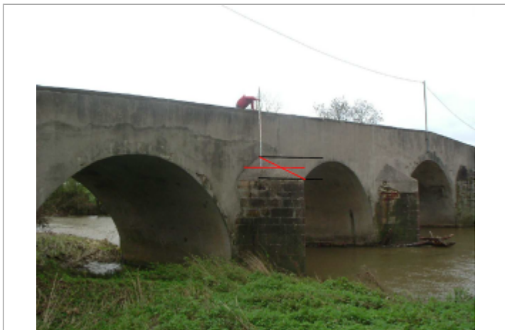
Pont RD14 - 88130 MARAINVILLE-SUR-MADON - Laisse de crue du 03/10/2006, 251,63m/NGF-IGN69
