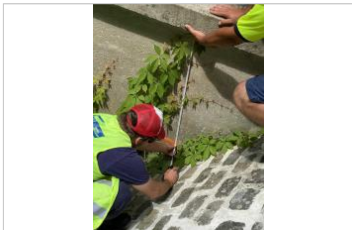
Marque de peinture sur tablier du pont à 1 m/ bas du tablier.
