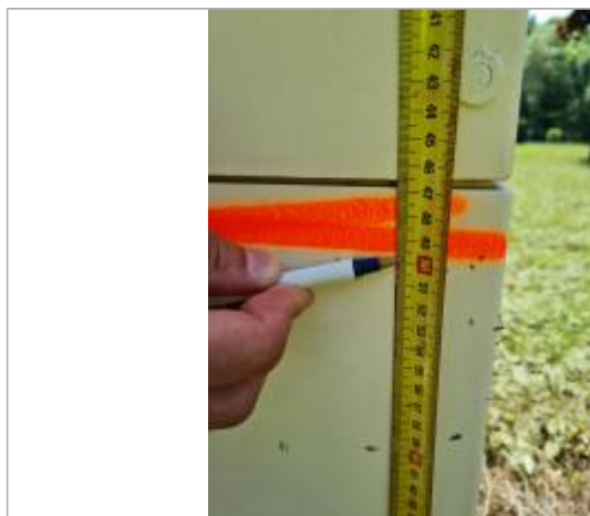
Marque peinte sur armoire électrique à 49,75 cm du haut de l'armoire.
