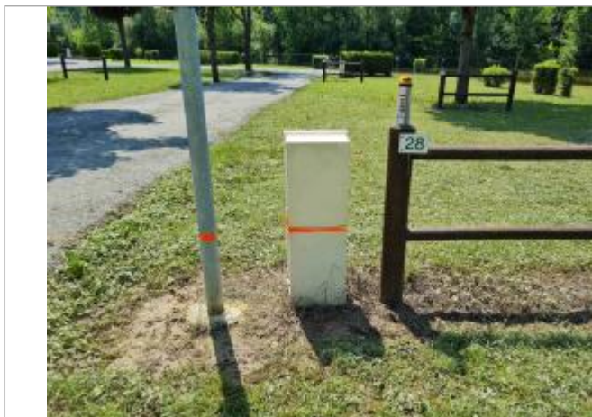
Armoire électrique dans Camping "Au bord de l'Aisne".
