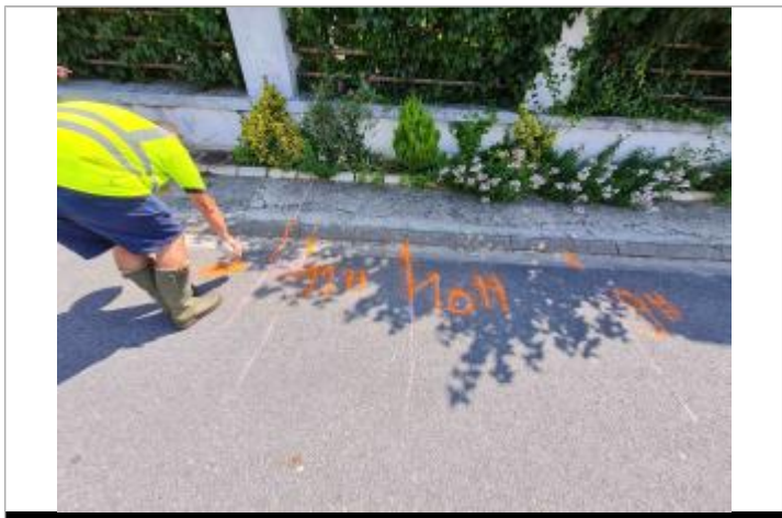
Marque de peinture, horodaté. (reporté sur les tubes de la cloture du n°3 de la rue à 26 cm/pile)
