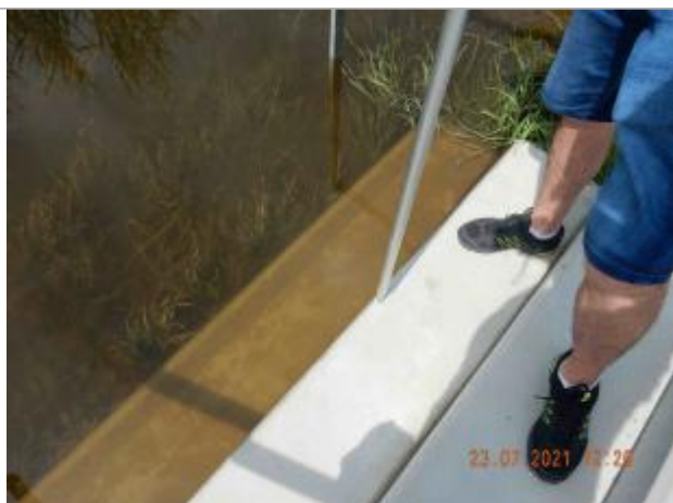
Trace d'humidité sur la 2 ème marche en partant du bas de l'escalier.
