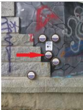
Repère normalisé de l'inondation du 29 décembre 1999
