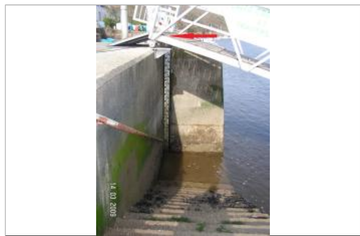
Echelle limnimétrique sous le ponton du port
