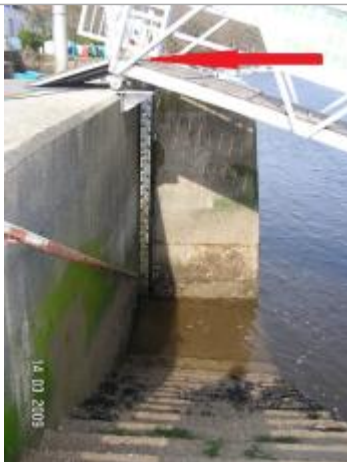
Echelle limnimétrique sous le ponton du port
