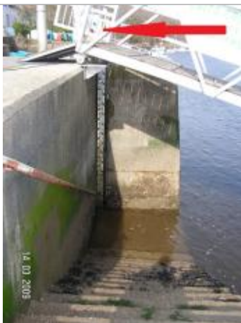
Echelle limnimétrique sous le ponton du port
