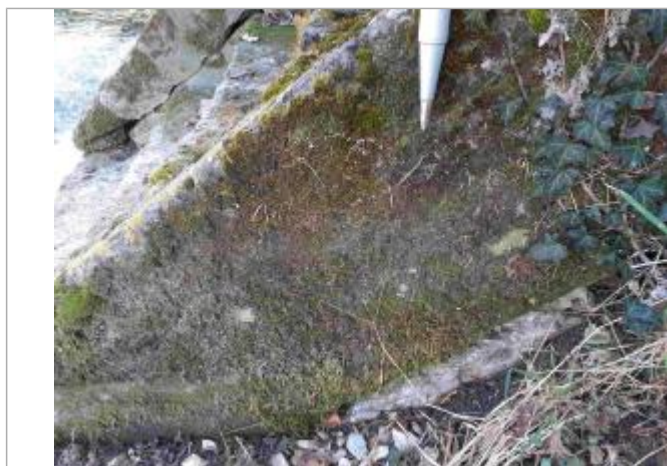
Débris de végétaux sur le côté de l'escalier, en aval du pont RG
