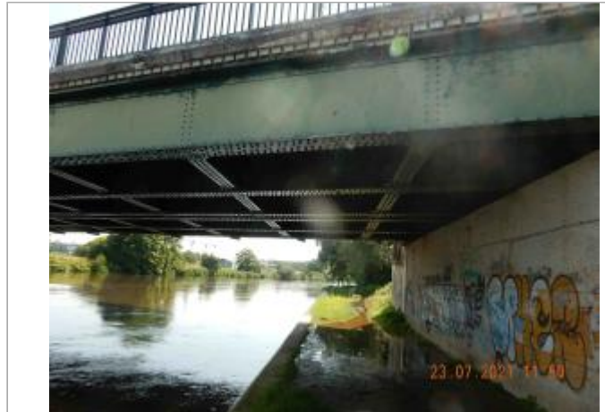
Bordure en ciment sur la berge en amont direct du pont Gambetta rive gauche.
